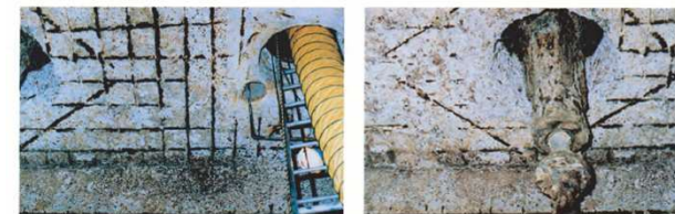
～JCI コンクリート構造物の劣化事例写真集～
