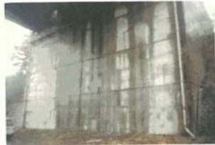
写真4.2.4-3 箱式橋台の腐食ひび割れと錆汁の発生状況(事例2)
